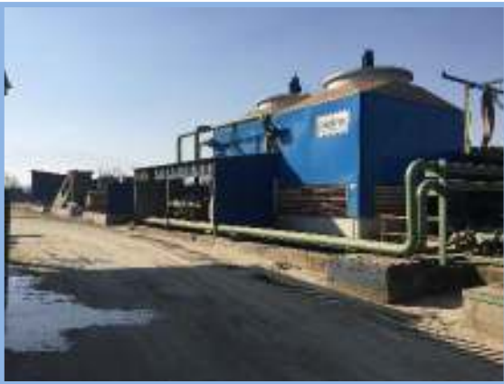
Su Soğutma Kulesi
