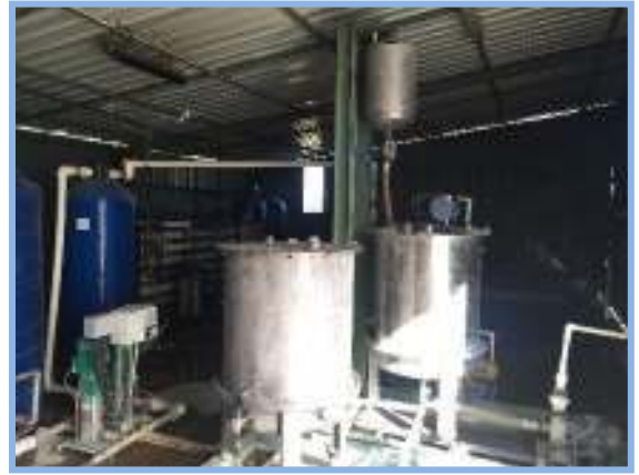
Asit Yıkama Ünitesi – İç Görünüm
